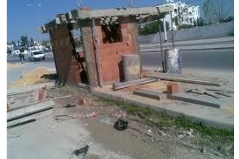
تجنب البناء الفوضوي
